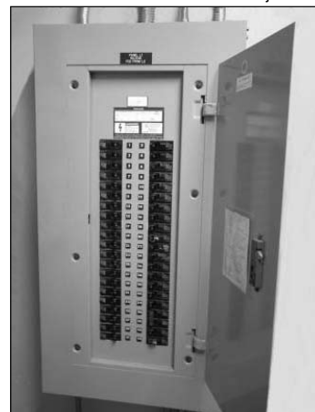
Panneau de disjoncteurs
