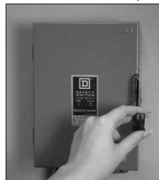
Boîte de disjonction
